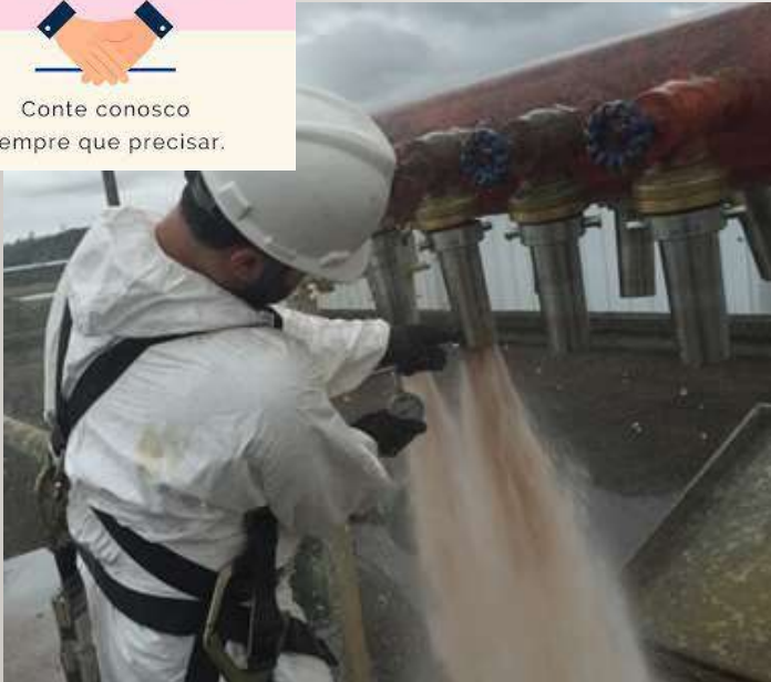
Imagem: Rava Campos Engenharia de Incêndio Teste de performance de motobombas
